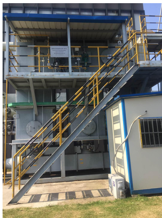
RTO 焚烧设备
