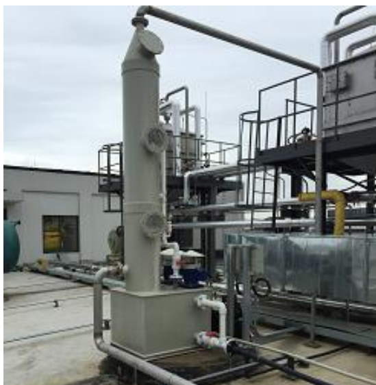
树脂吸附前喷淋塔
