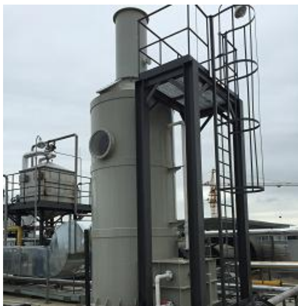
树脂吸附后喷淋塔
